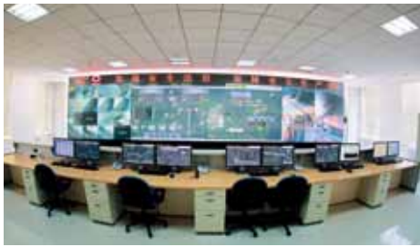
无人值守水泥生产线中控室
